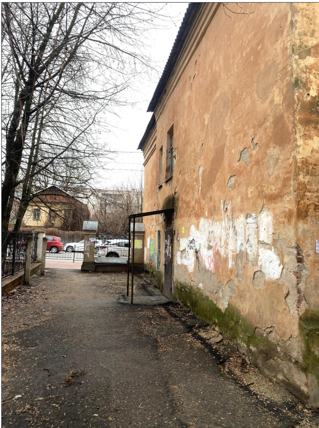
Т.ф. 1. Памятник. Боковой (северо-восточный) фасад. Состояние штукатурной отделки, цоколя, отмостки. Дата 11.04.2022. Автор А.Ф. Мартынов
