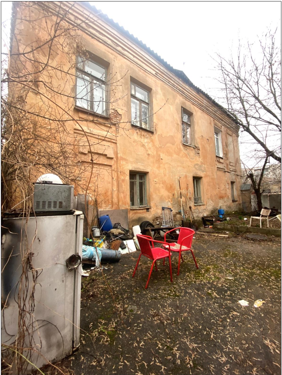
Т.ф. 2. Памятник. Боковой (юго-западный) фасад. Нарушение геометрии оконных осей и декоративной отделки. Дата 11.04.2022. Автор А.Ф. Мартынов
