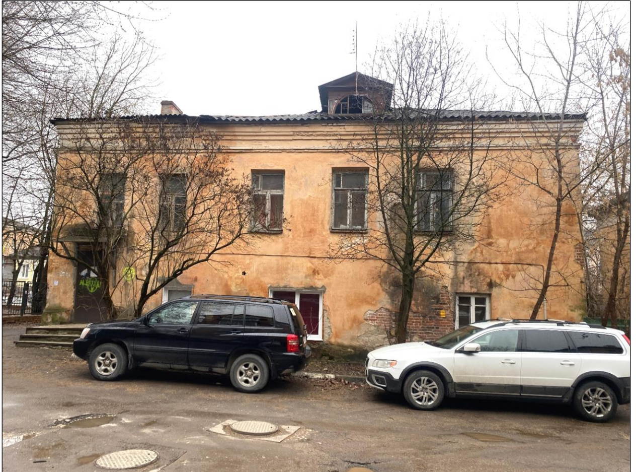
Т.ф. 6. Памятник. Дворовой (северо-западный) фасад. Нарушение геометрии оконных осей и декоративной отделки. Чердачное окно. Автопарковка вблизи объекта экспертизы. Дата 11.04.2022. Автор А.Ф. Мартынов
