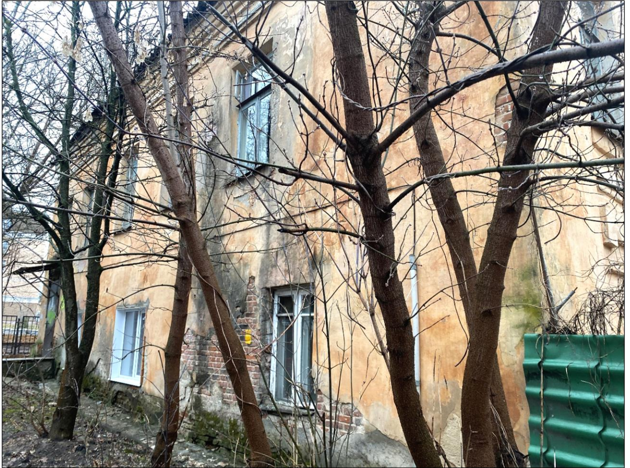
Т.ф. 2. Памятник. Дворовой (северо-западный) фасад. Нарушение геометрии оконных осей и декоративной отделки. Состояние штукатурной отделки, намокание кирпичных стен. Дата 11.04.2022. Автор А.Ф. Мартынов
